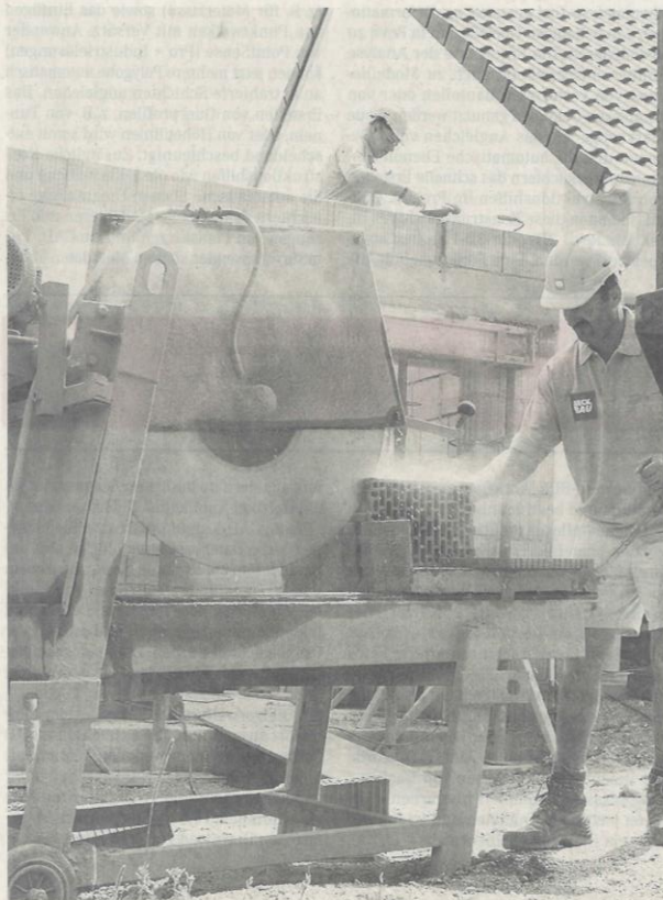
Seit diesem Jahr setzt das Bauunternehmen Beck Bau bei jedem Projekt eine Planungs-Software von Soulsurf ein. Die zentralisierte und digitale Datensammlung ermöglicht dem Unternehmen eine 30 %ige Zeitersparnis. Foto: Beck Bau
